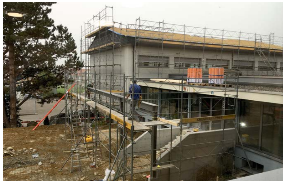
Der Eingang zum Schulhaus während der Entstehung und Reparaturarbeiten am Dach der Turnhalle aufgrund der Hagelschäden.
